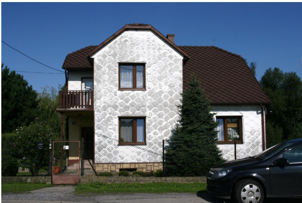
Rysunek 2 Elewacja pokryta płytami azbestowymi płaskimi zlokalizowany na terenie Gminy Wilamowice, sołectwo Heczmarowice
