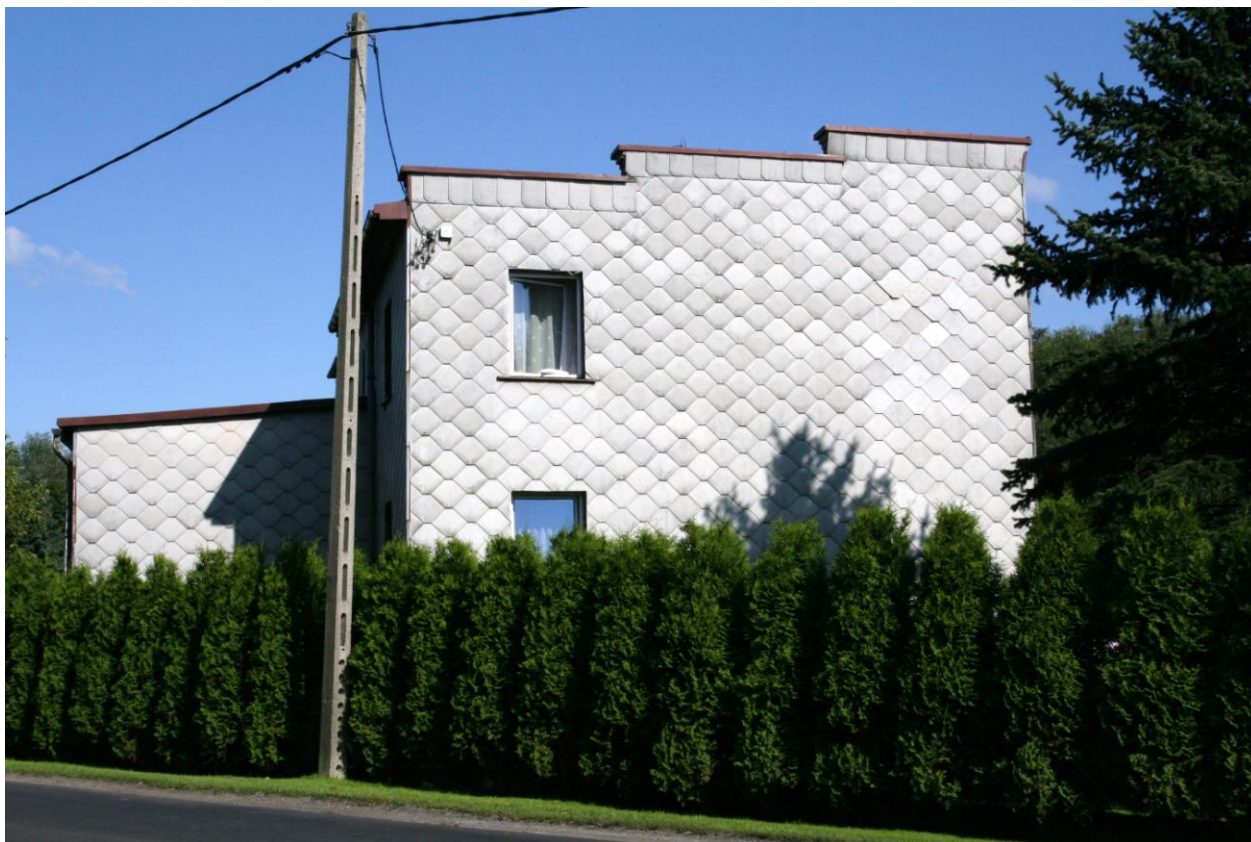
Rysunek 4 Elewacja pokryta płytami azbestowymi płaskimi zlokalizowany na terenie Gminy Wilamowice, sołectwo Hecznarowice (III stopień pilności)
