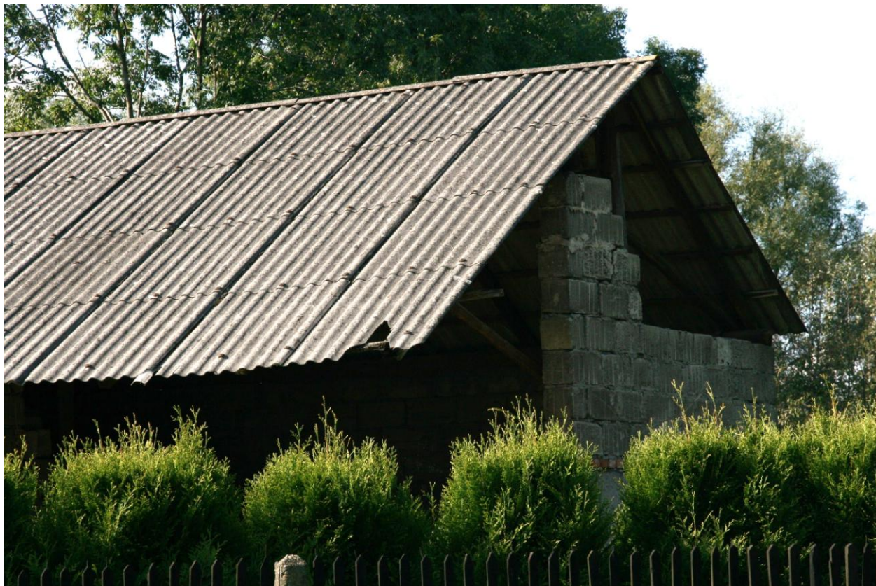
Rysunek 3 Dach budynku gospodarczego pokryty płytami azbestowymi falistymi zlokalizowany na terenie Gminy Wilamowice, sołectwo Hecznarowice
